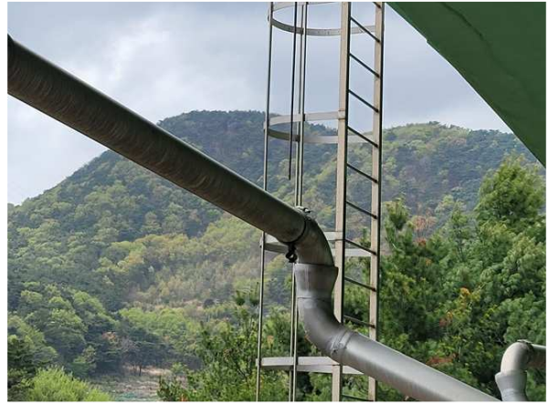
배수관 고정대 탈락
